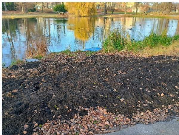
Fot. 3 Lokalizacja mnicha na środku grobli – widok od strony Stawu Południowego – przy brzegu widoczna niebieska plandeka i wystające big-bagi stanowiące tymczasowe zabezpieczenie
